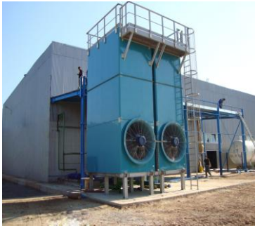
Tour de refroidissement
