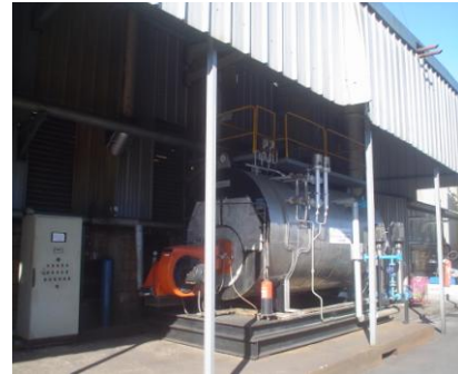
Chaudière et circuit vapeur
